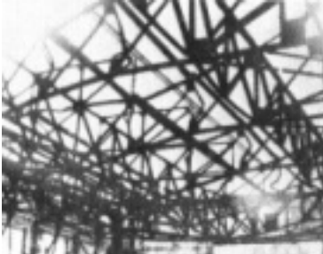
講堂の焼け跡(東陽小学校)
