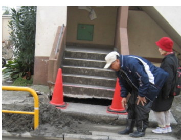
辰巳10街区階段下の陥没
